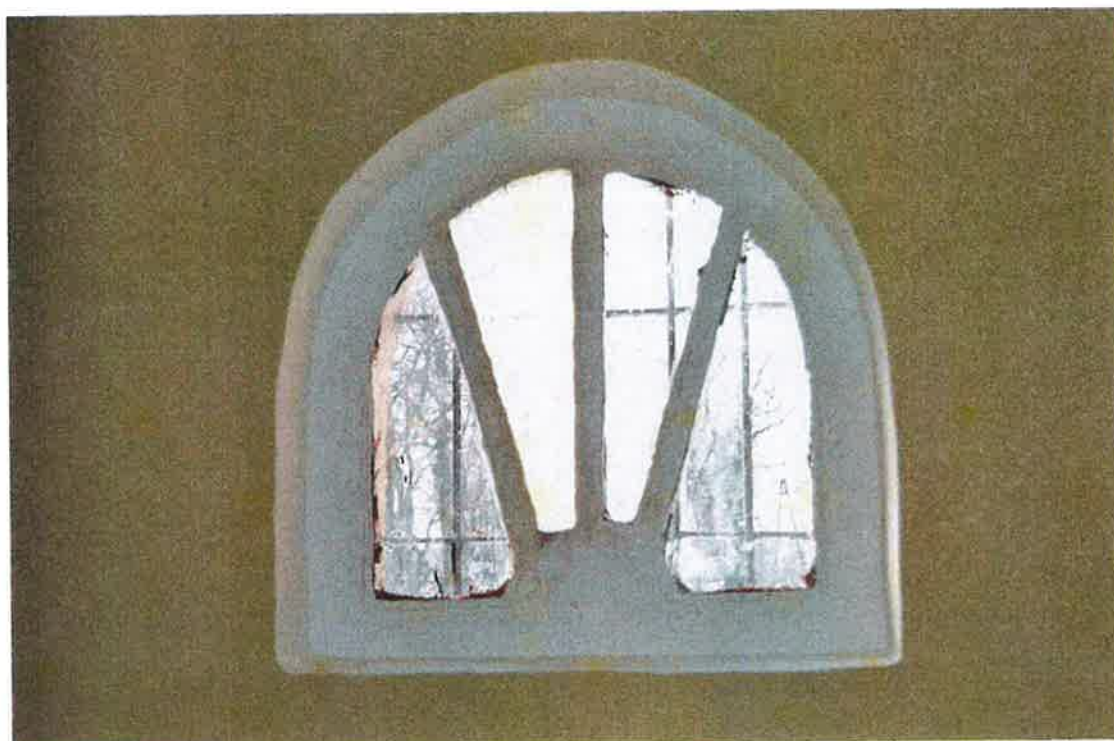
II. 28 Chełmce, Kościół parafialny p.w. Św. Katarzyny – zakrystia, elewacja zachodnia - widok na rewers pierwotnej stolarki okiennej
