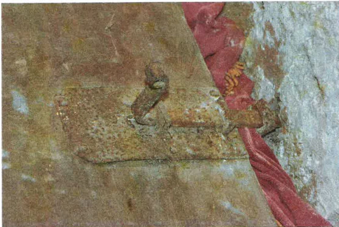
II. 19 Chełmce, Kościół parafialny p.w. Św. Katarzyny Aleksandryjskiej, wieża, okiennice - widok na pierwotną zasuwkę wierzchnią, stalową, zamykającą pierwotne okiennice
