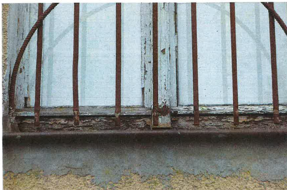
Il. 22 Chełmce, Kościół parafialny p.w. Św. Katarzyny – zakrystia, elewacja południowa - widok na fragment stolarki okiennej z 20-lecia międzywojennego XX w. oraz źle zamontowany parapet fot. Ewa Bożejwicz 2023 r.
