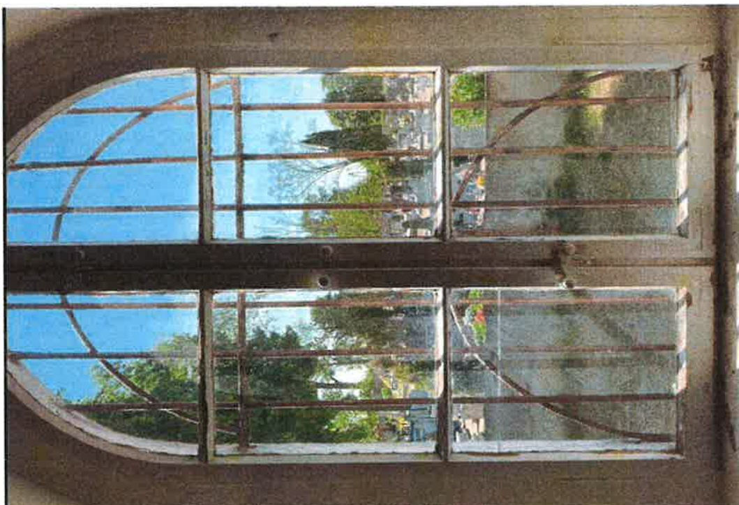
Il. 24 Chełmce, Kościół parafialny p.w. Św. Katarzyny – zakrystia, elewacja południowa - widok na rewers stolarki okiennej pochodzącej najprawdopodobniej z 20-lecia międzywojennego XX w.
