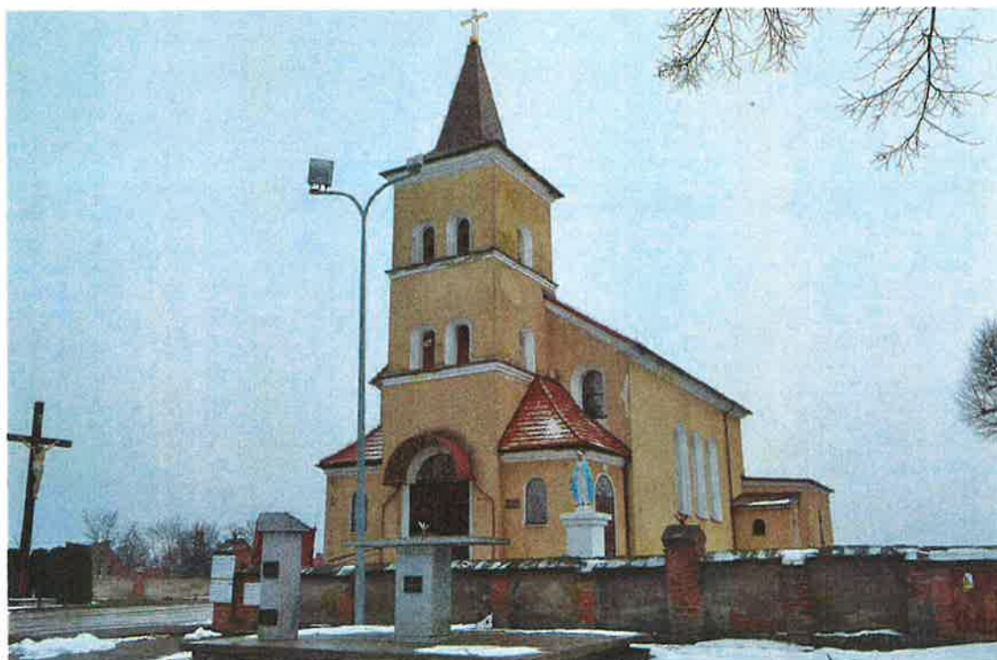
II. 4 Chełmce, Kościół parafialny p.w. Św. Katarzyny Aleksandryjskiej - widok na elewację południową i zachodnią
