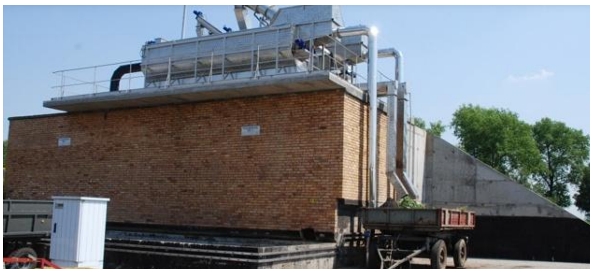
Fot. 15 Oczyszczalnia ścieków w Kruszwicy
