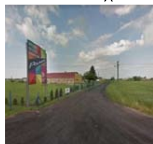
droga gminna w Przedbojewicach przed przebudową
